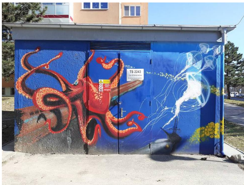
Obrázek 119: Nabarvená trafostanice v Líšni.
