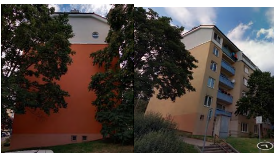
Lok. 13. Popelákova 8 a 24 severovýchodní stěna a Popelákova 2 a 11 stěna s jihozápadní expozicí poskytují obdobné podmínky pro umístění budek pro rorýse a poštolku jako je tomu na lokalitě 12.
